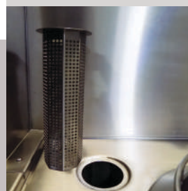
Canaleta de drenaje con bote de malla para evitar atascos.
