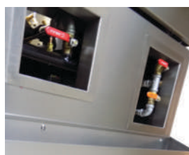
Control de flama por medio de válvulas.
